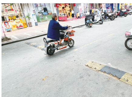
道路中间减速带因长期使用出现破损
