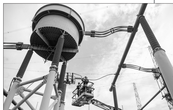
▲世界最高电压等级换流站完成“体检” 10月9日,国网安徽电力检修人员对古泉换流站设备进行检修、维护。当日,昌吉—古泉±1100千伏特高压直流输电线路的受端站——安徽宣城古泉换流站完成“体检”。昌吉—古泉±1100千伏特高压直流输电工程起于新疆昌吉换流站,止于安徽古泉换流站,是目前世界上电压等级最高、输电距离最远、输送容量最大的输电工程。(新华)
