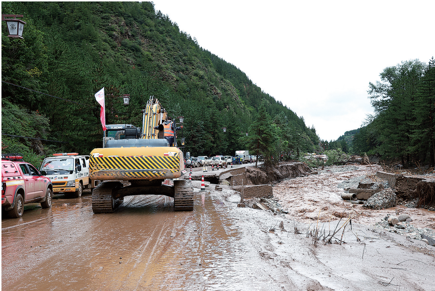
▲甘肃榆中强降雨引发山洪灾害 现场救援进行中 8月8日,救援人员在兰州市榆中县城关镇兴隆山村开展救援。8月7日以来,兰州市多地出现大范围强降雨,截至8日12时,最大降水量出现在榆中县,达220.2毫米。强降雨引发山洪灾害,榆中县城关镇、马坡乡、小康营乡、夏官营镇等多个乡镇受灾。截至目前,山洪灾害已造成10人死亡、33人失联。目前,各项应急救援工作正在紧张进行。(新华)
