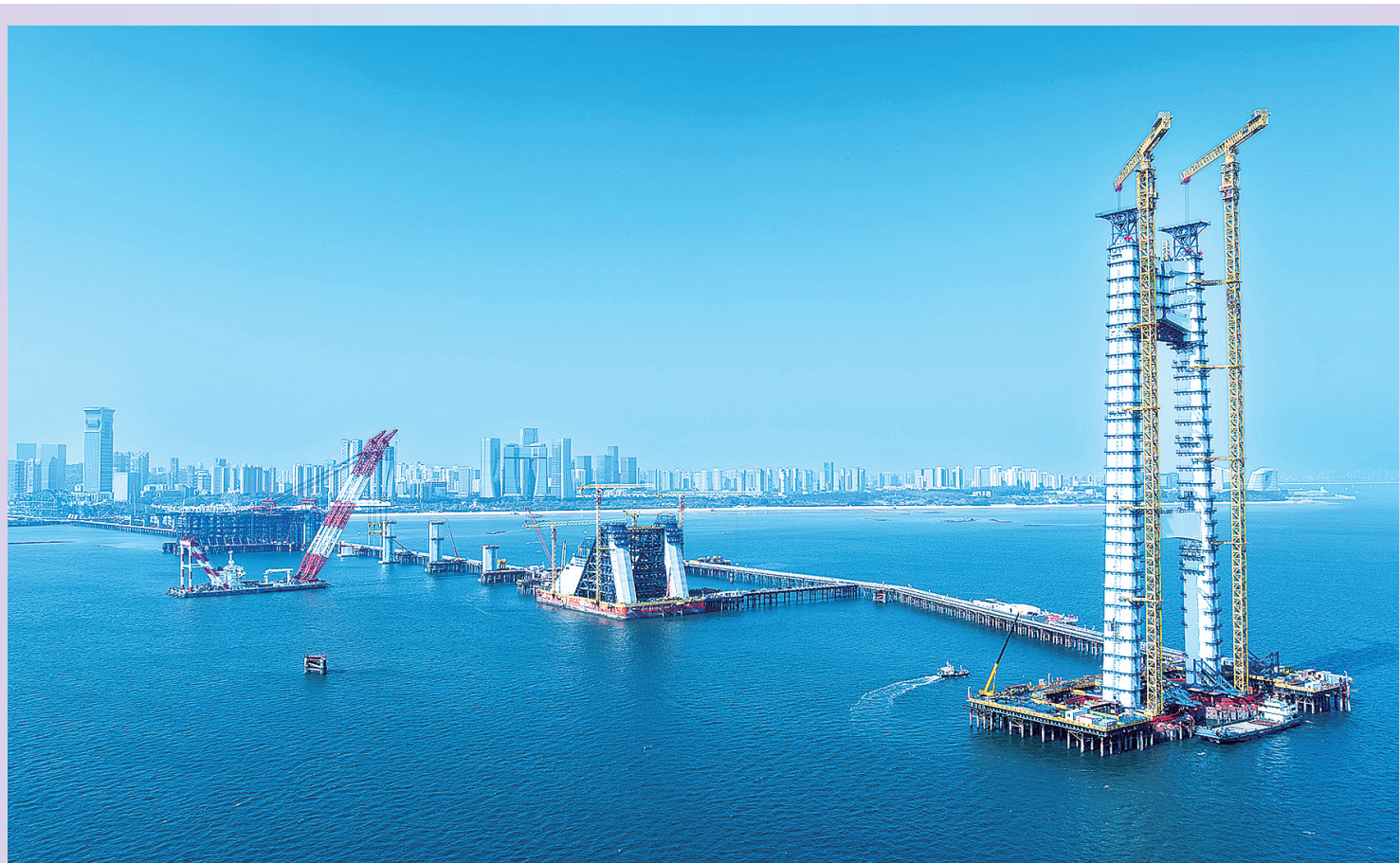
▲厦金大桥(厦门段)项目各项施工进展顺利 这是建设中的厦金大桥(厦门段)项目A1标段全景(2026年1月9日摄，无人机照片)。目前，厦金大桥(厦门段)项目跨海工程已从“立塔成型”转入“悬索成桥”关键施工阶段。厦金大桥(厦门段)项目于2023年10月动工，路线全长约19.6公里，其中主线长约17.34公里，翔安支线总长约2.27公里。(新华)
