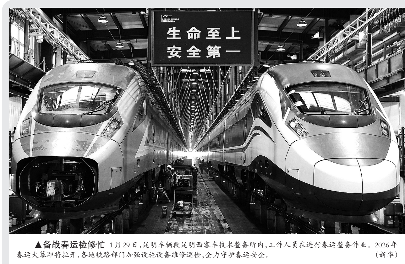
▲备春运检修忙 1月29日,昆明车辆段昆明西客车技术整备所内,工作人员在进行春运整备作业。2026年春运大幕即将拉开,各地铁路部门加强设施设备维修巡检,全力守护春运安全。(新华)
