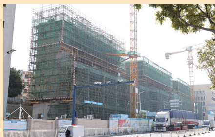
2月4日,记者走访石狮鹏山工贸学校改扩建项目获悉,新建的三栋公寓型学生宿舍楼已施工至6层,将在今年秋季新学期前建成交付。(记者 康清辉 李荣鑫)
